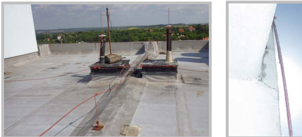
Obr. č 27 a 28 (vedení hromosvodu na střeše/fasádě):
