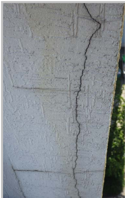
Obr. č 5 a 6 (trhliny v zateplovacím systému):
